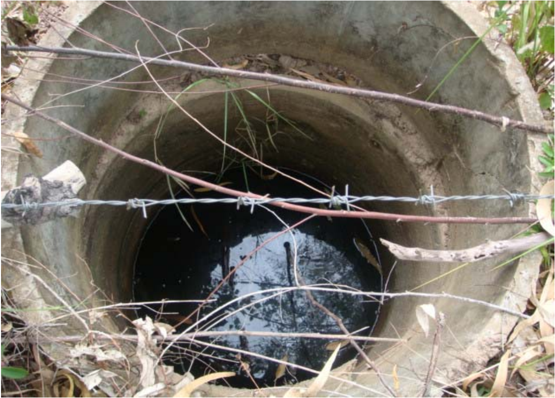
บ่อน้ำดินระบบท่อปูนซีเมนต์
